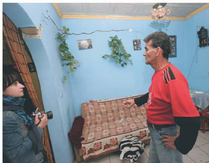
Väggarna har spruckit på grund av vattnet.
